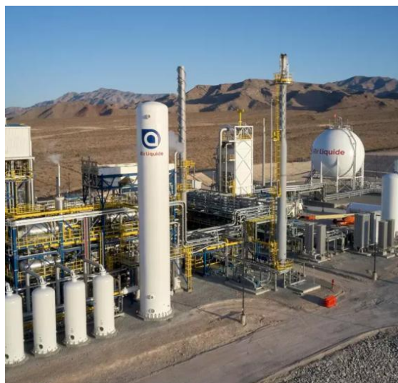
Figura 24 - Impianto da 30 t/d 22
